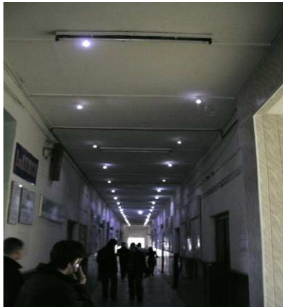
Рисунок 6 – Світлодіодні освітлювачі для внутрішнього освітлення приміщень
